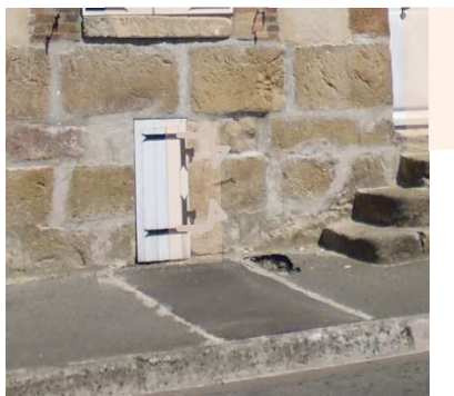
Coffret électrique derrière une porte en bois
